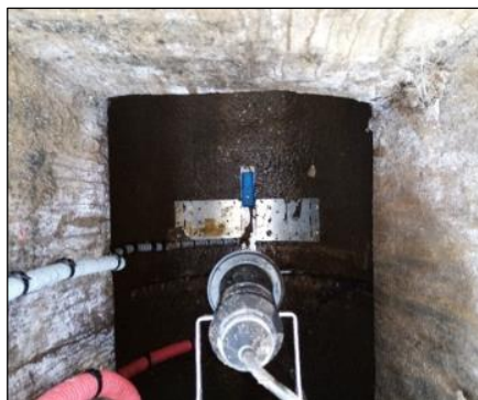
Figure 30 : Regard de mesure de déversement
