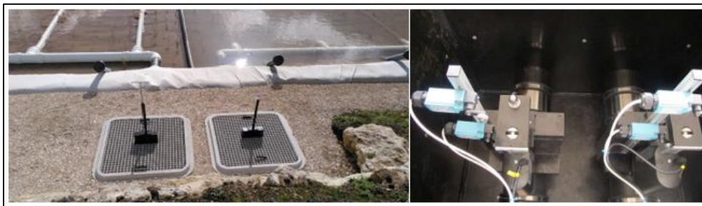
Photo 5 - Exemple de vannes motorisées par vérin électrique sur réseau gravitaire
