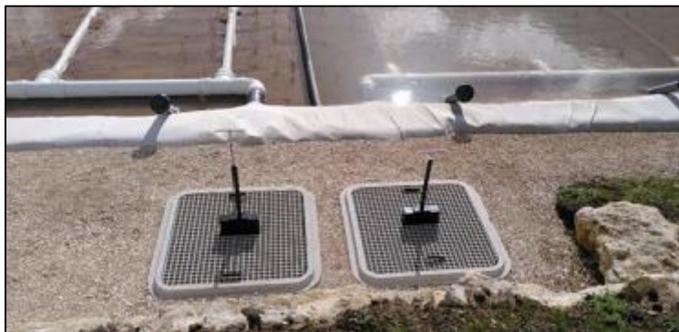
Photo 3 - Exemple de vanne manuelle
