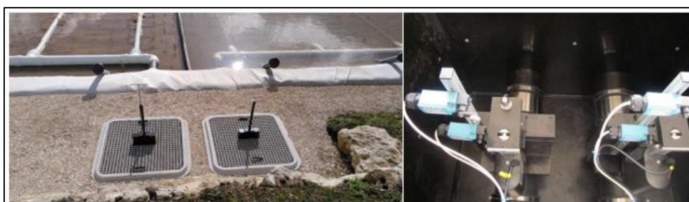
Photo 1 - Exemple de vannes motorisées par vérin électrique sur réseau gravitaire
