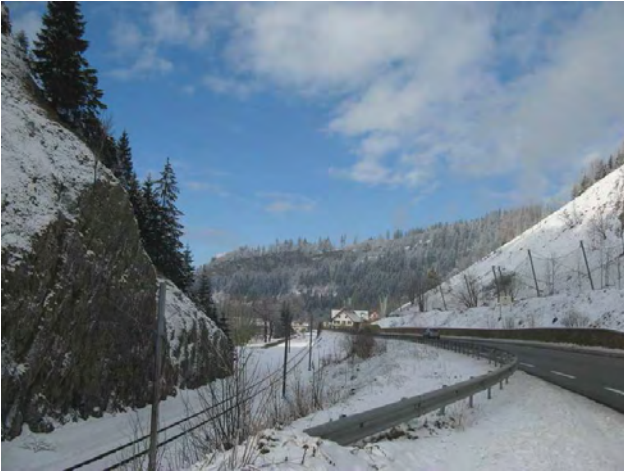
Risque d'éboulement dans la cluse de Joux (25) (photo BRGM).
