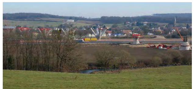
Configuration susceptible de créer un effet de site dans la plaine alluviale de la Savoureuse (90), avec le viaduc de la LGV Rhin-Rhône, dimensionné pour ce phénomène (photo BRGM).
