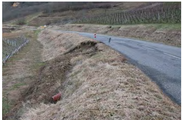
Exemple de glissement de talus routier à Château-Chalon (39) (photo BRGM).
