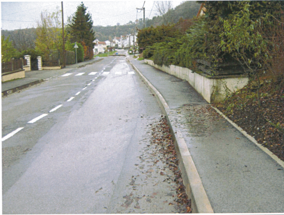
photo n°5 : rue de Gravelle, arrivée d'eau importante suite à un épisode pluvieux.
