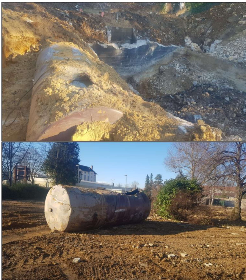
Figure 8 : Photographies de la cuve avant son enlèvement du site– Perl Environnement (janvier 2022)
